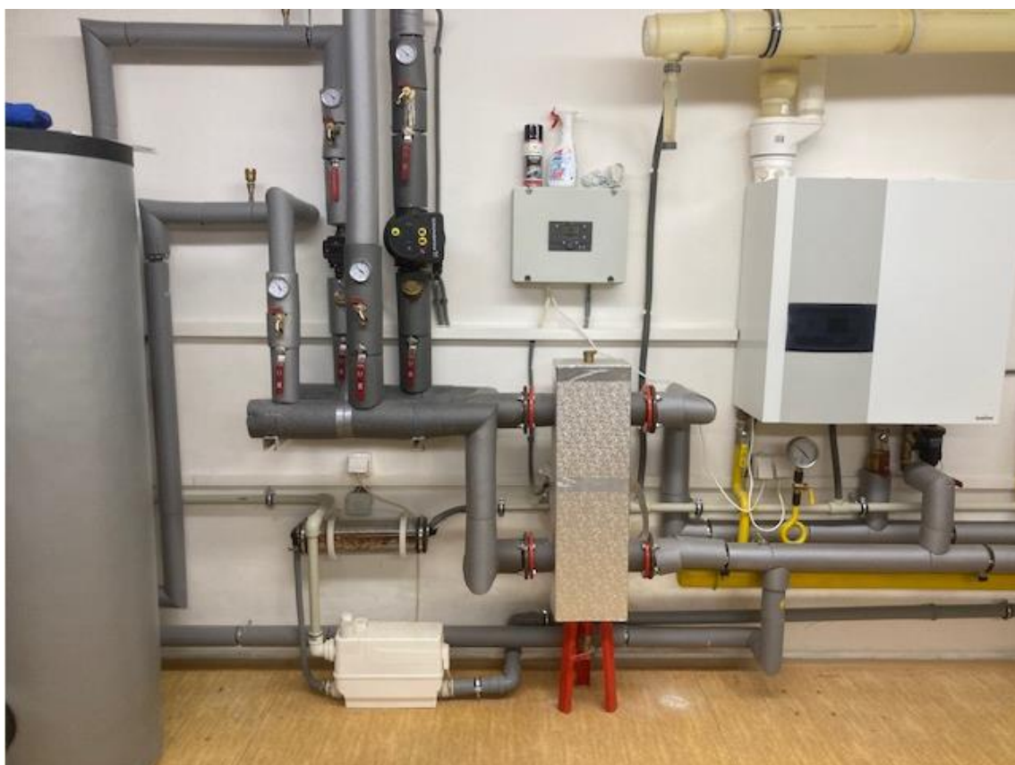
plynové vytápění na 1. stupni
